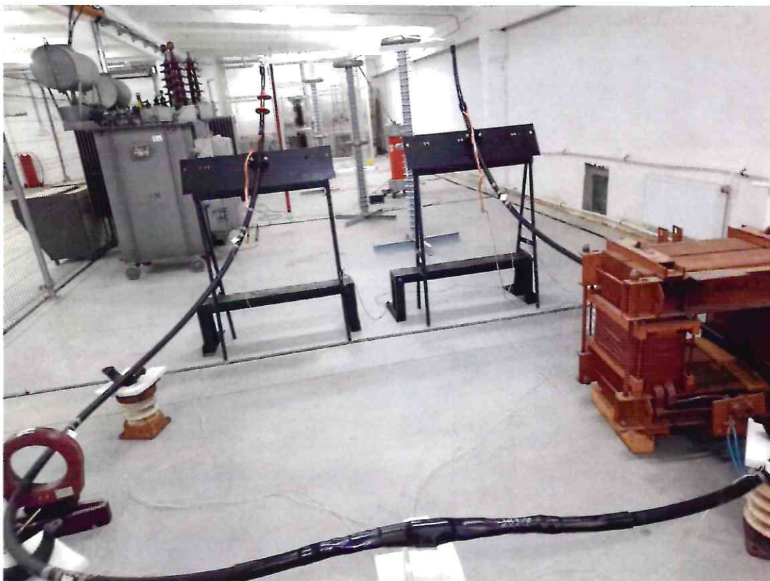
а) Испытательная кабельная сборка на напряжение 10 кВ
