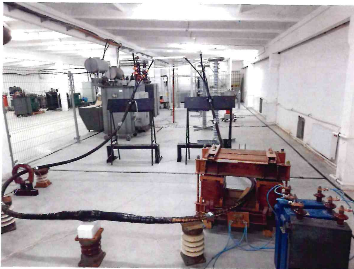
а) Испытательная кабельная сборка на напряжение 10 кВ
